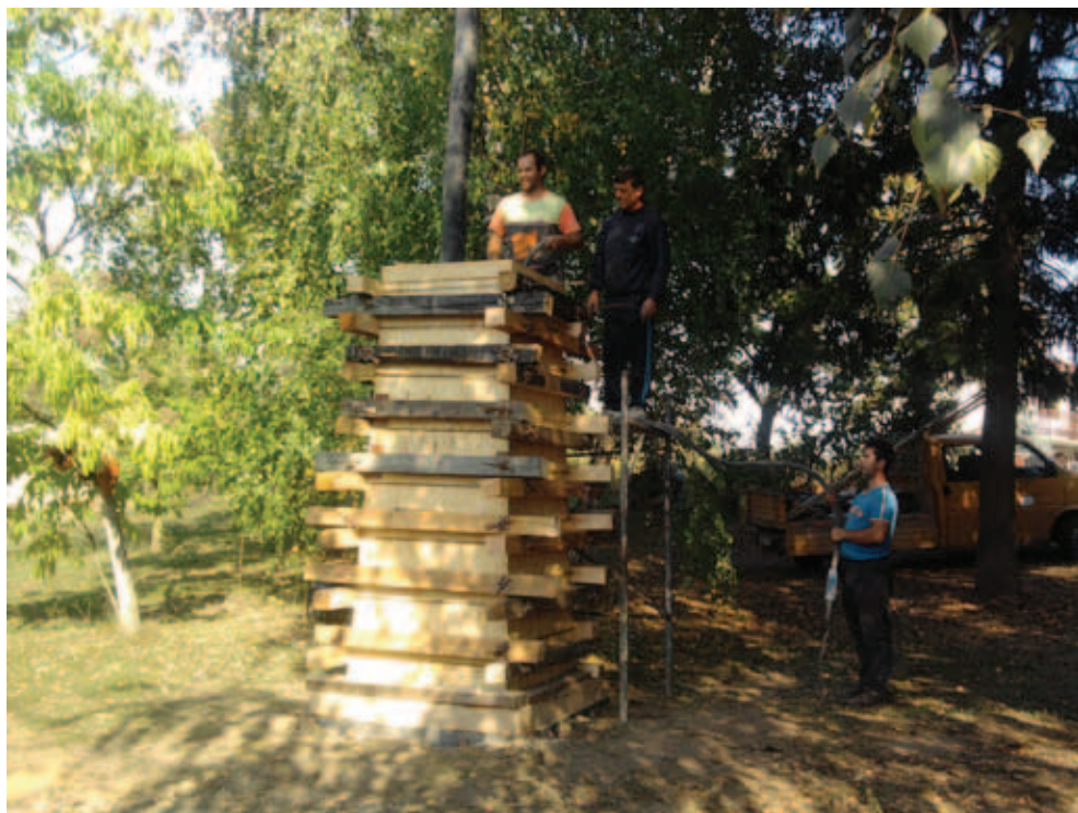
Ulijevanje betonske mase u kalup za spomenik, 5. listopada 2009. (foto: Ivan Sić, dipl.ing.)
